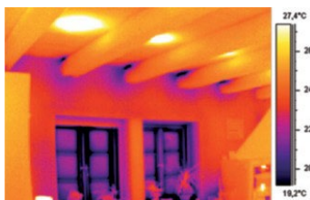
Pont thermique à l'un des étages.
